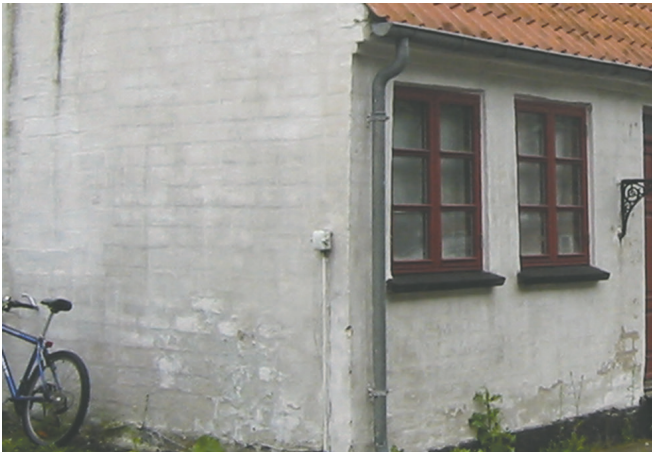
Kridtstenshuse i Store Heddinge med tydelige spor efter opfugtning af ydermuren fra opadstigende grundfugt. Her bør der udføres en fugtspærre af indlagte skiferplader eller lignende lige
