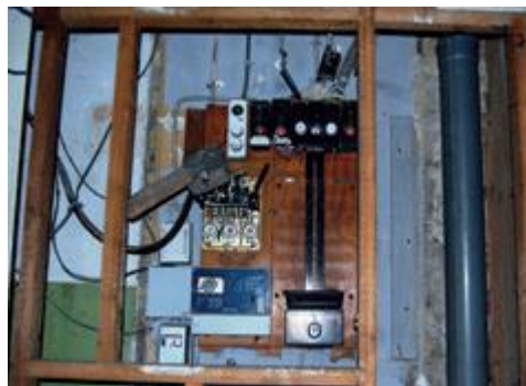
Eltavle kan indeholde relæer og andet elektrisk udstyr, der kan indeholde PCB og kviksølv.
