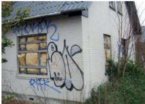
Kondemneret hus malet med blyholdig murlaling. Før nedrivning skal malingen renses af og opsamlet for korrekt bortskaffelse.
