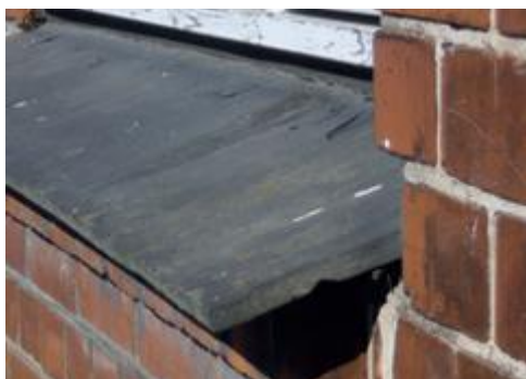
Sålbænk – kan indeholde asbest. Hvis der er usikkerhed om indholdet af asbest, skal materialerne håndteres som om de indeholder asbest. Ved større mængder skal der foretages analyse.
