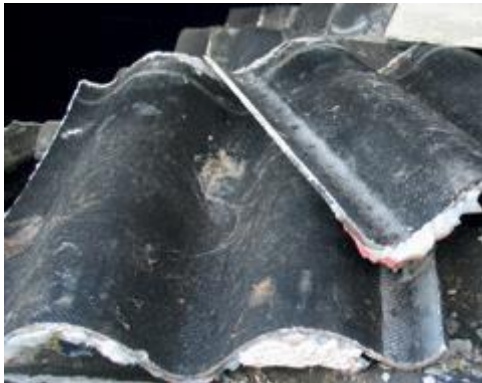
Eternitplader. Ældre eternitplader indeholder asbest. Pladerne skal deponeres, og må ikke slås i stykker.
