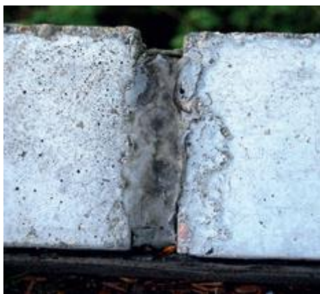
Betonelementer med PCB-holdig fuger i byggeri fra 60'erne.
