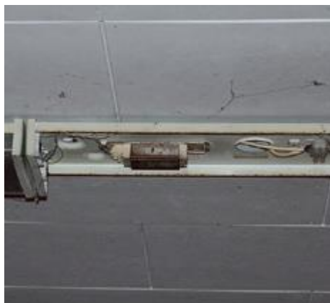
Ældre armaturer til lysstofrør indeholder ofte PCB.
