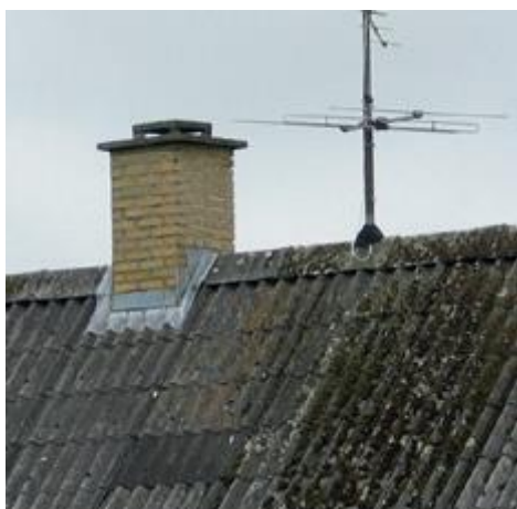
Ældre eternittage indeholder som oftest asbest.
