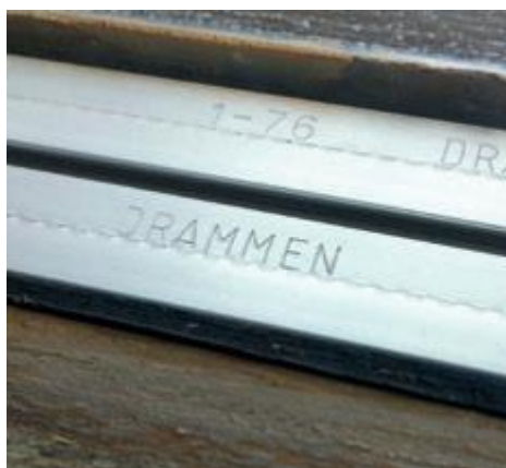
Prægningen i rudens afstandsliste viser, at ruden er fremstillet i januar 1976 (1-76). Ruden kan derfor indeholde PCB.
