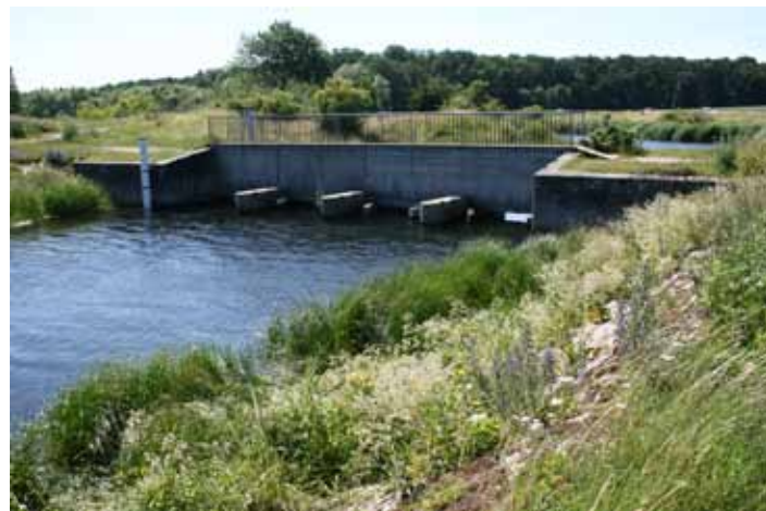
Slusen ved udløbet, som sikrer mod tilbageløb.
