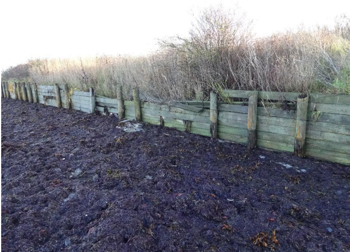
Figur 34: Område af træflagevæg på det midterste stykke af ledeværket, som er i meget dårlig stand.
