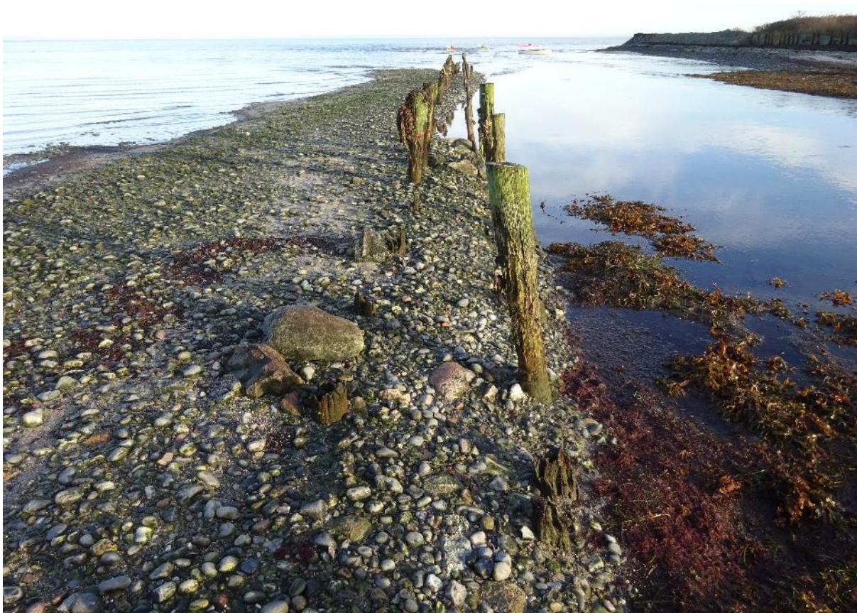
Figur 41: Pæle i det gamle ledeværk mod vest er rådnet væk.
